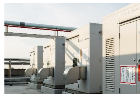
【関東工場フリーザー用冷凍機】
